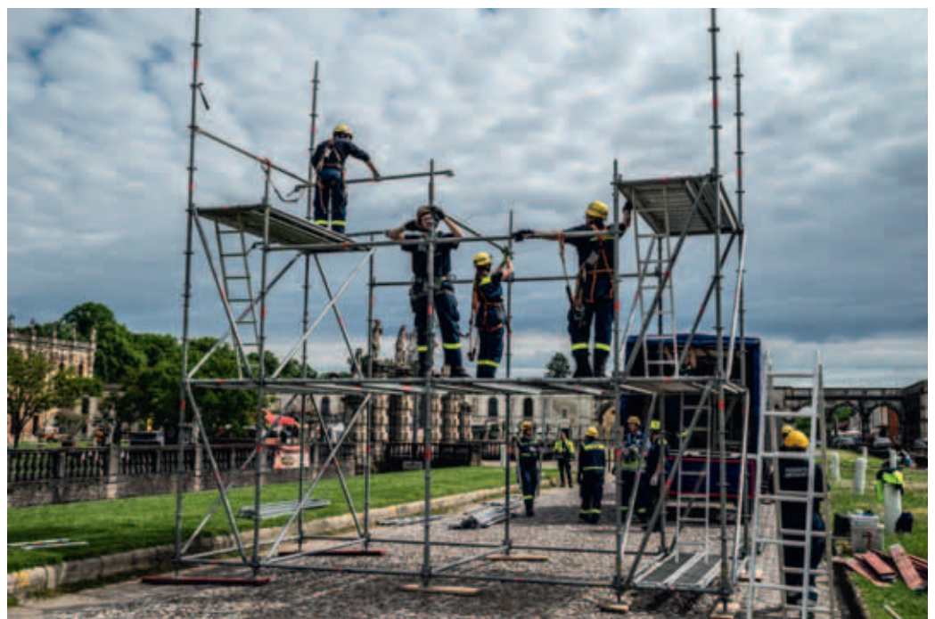
Die Dekonschleuse aus EGS wird in Piazzola aufgebaut. Rund 200 EGS Teile benötigt diese Konstruktion.
