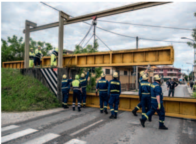
Das Fluttur in Limena wird geschlossen. Es besteht aus schweren Eisenteilen, welche sich so verkanten, dass kein Wasser hindurch kommt.
